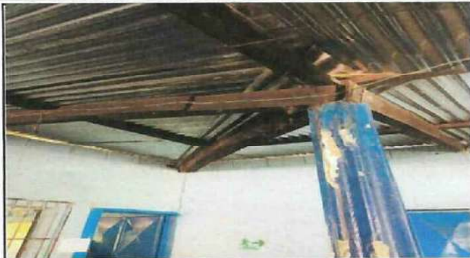
Foto 2: Se puede observar que la estructura del techo se necesita cambiar del modulo 1 tipo L de 6 aulas.
