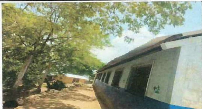
Foto1: Se puede observar que la cubierta de lámina se necesita cambiar del modulo 1 tipo L de 6 aulas.
